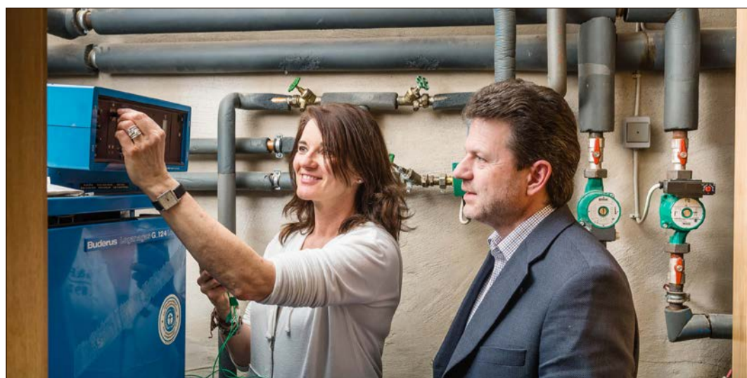
Im Rahmen der Kampagne „clever heizen!“ der Energieagentur Heidekreis wird unter anderem der Zustand der Heizungsanlage aufgenommen und bewertet. Foto: Klimaschutz- und Energieagentur Niedersachsen / Stefan Koch
