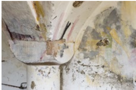
An den Kreuzgratgewölben erkennt man die Spuren der Zeit.
