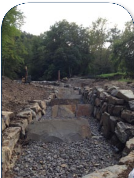
Die Fischaufstiegsanlage nach dem Umbau: optimierte Durchgängigkeit für die Leitart Lachs.
