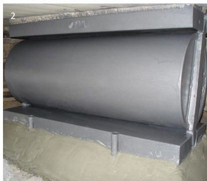
1 Korrodiertes Rollenlager 2 Instand gesetztes Rollenlager
